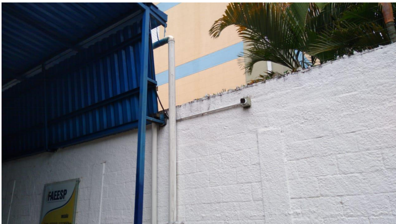
Imagem 2: Instalação de Câmeras na Entrada do prédio. Foto tirada em: 02/03/2020. Acervo da Instituição.
