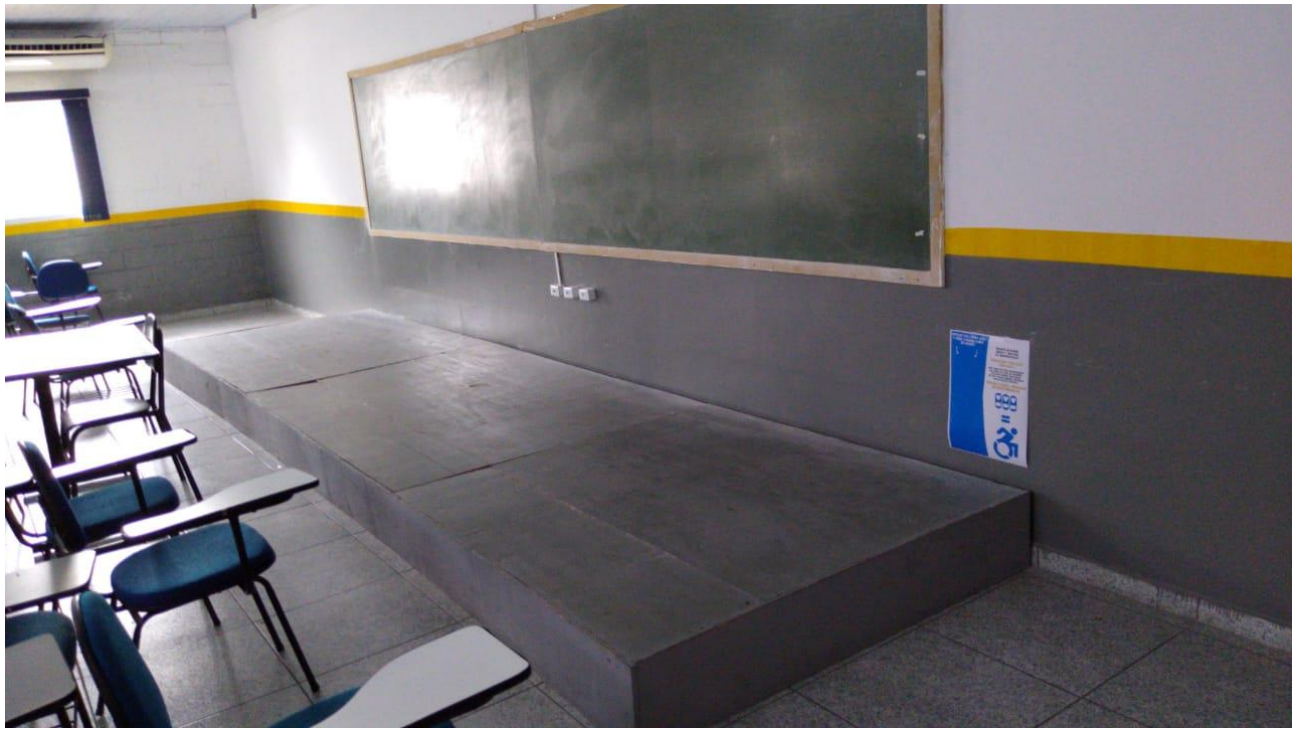
Imagem 8: Reforma na instalação de iluminação e paredes.. Foto tirada em: 02/03/2020. Acervo da Instituição.
